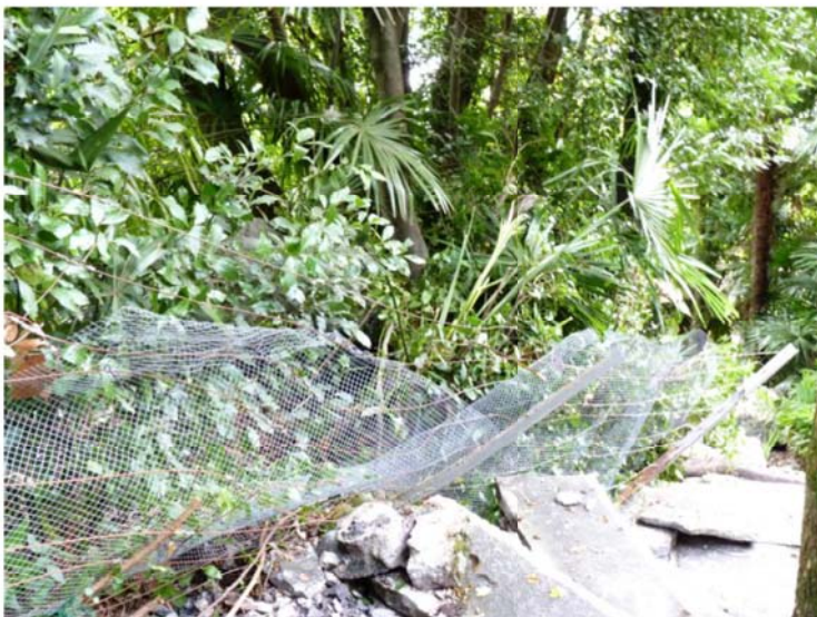
Foto 5: danneggiamento del sentiero e della recinzione (ca. 455 mslm)
