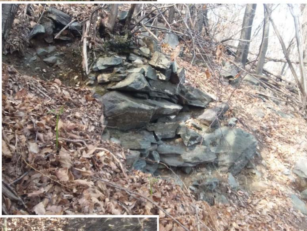
Foto 08 Tracce di vecchi muri a secco in condizioni precarie, con possibili rimobilizzazioni di sassi e blocchi.
