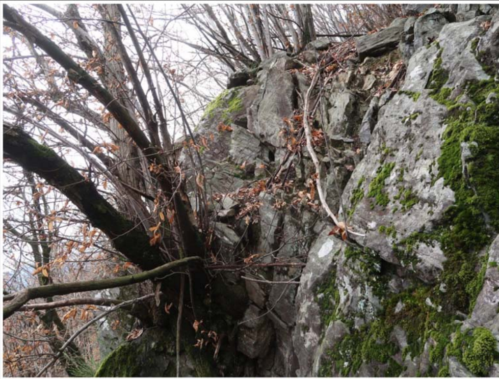
Foto 10 Zona di stacco dalla parete rocciosa uncinata, con alberi e radici, cresciuti nelle fessure, che possono generare stacchi di blocchi.
